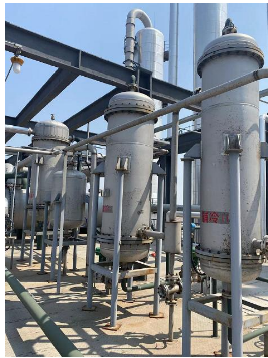
酒精回收废气收集管道
