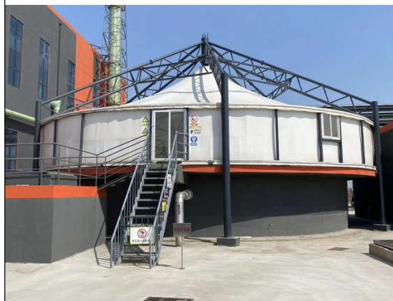
污水站设施—污泥浓缩池
