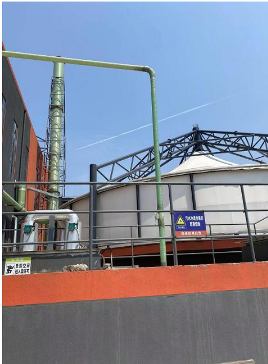
污水处理站废气收集管道
