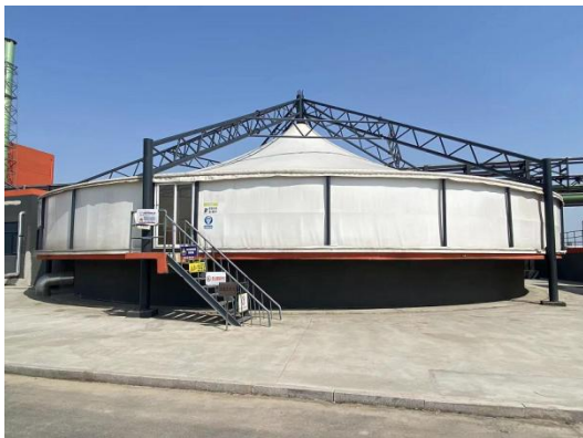
污水站设施—混凝沉淀池
