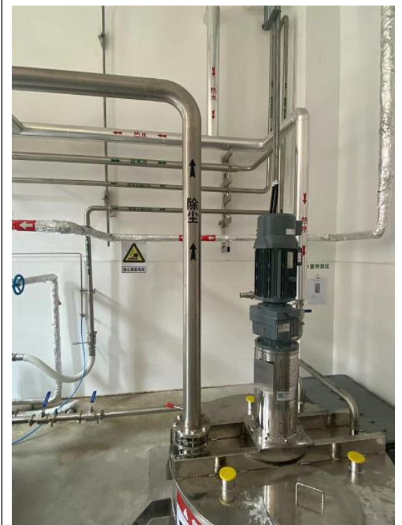
投料废气收集管道
