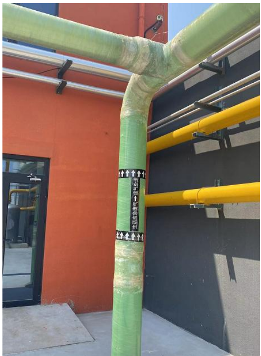
污水处理站废气收集管道
