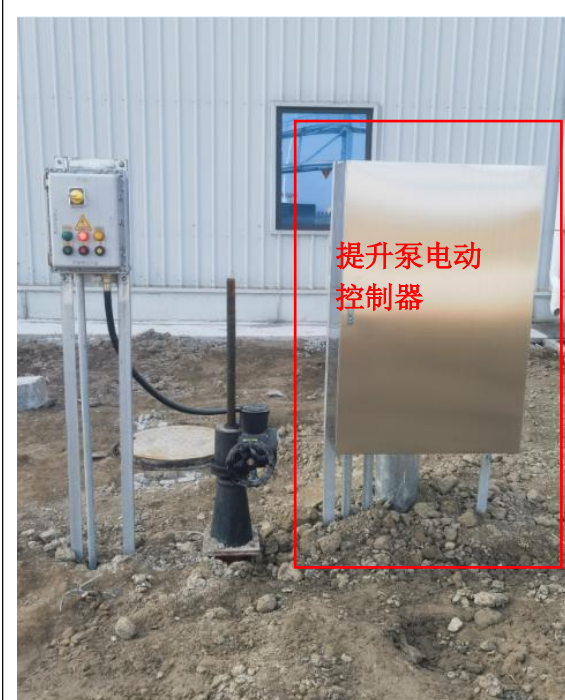
雨水排放口 2 截止阀及提升泵
