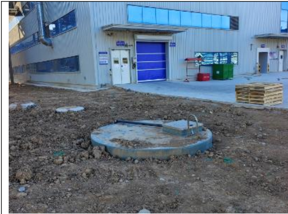
820.830 车间外废水收集罐
