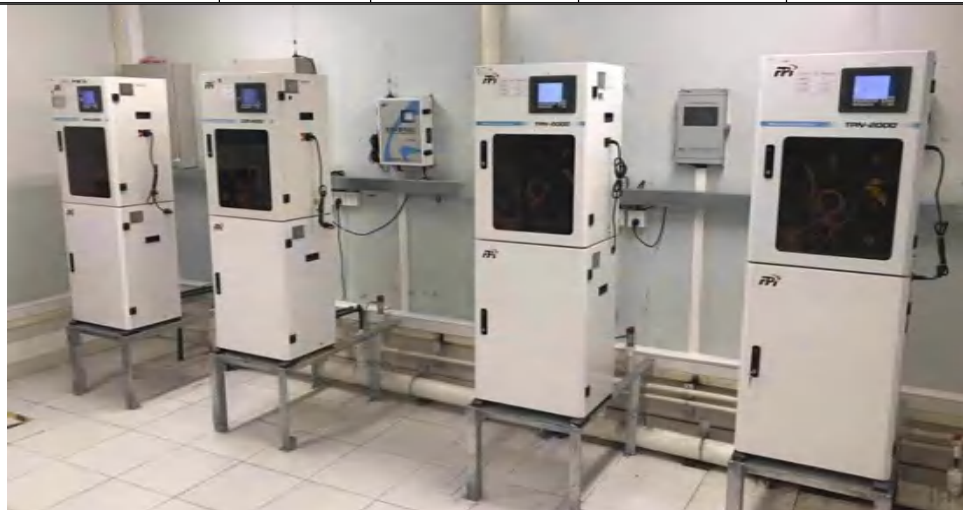
废水总排口 COD、氨氮、总磷、总氮在线监测设备
