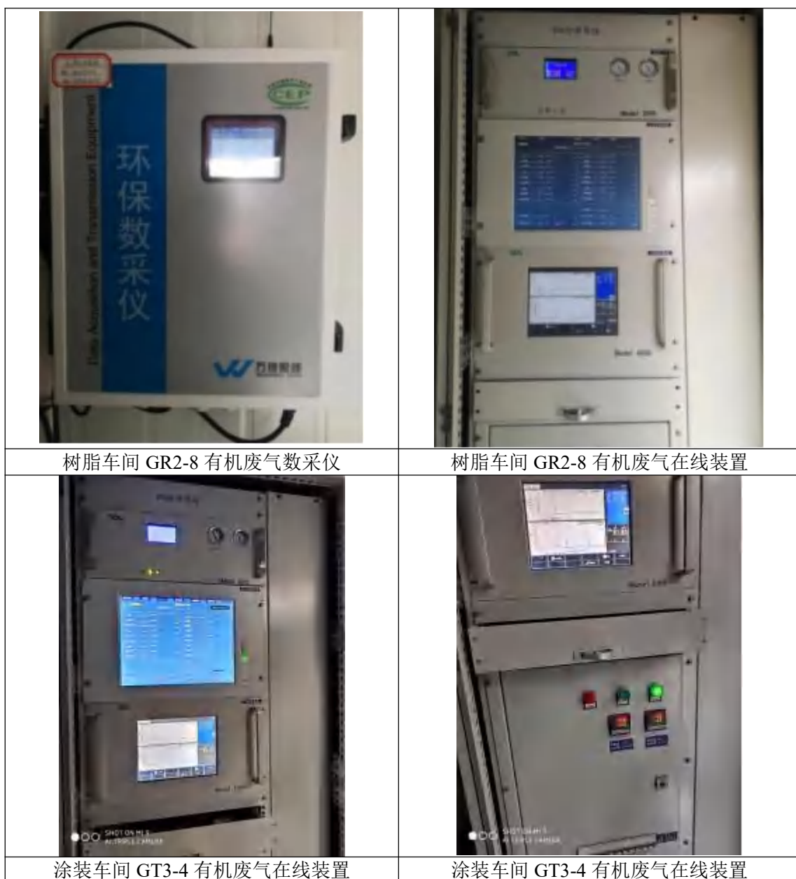
图 3.5-1 废气在线监测装置照片
