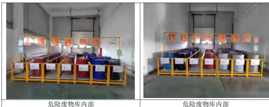
图 3.4-1 固体废物设施照片
