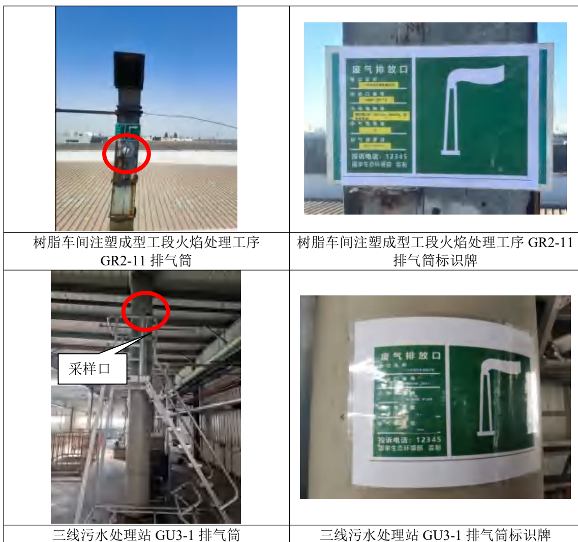
图 3.2-1 废气处理设施照片
