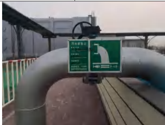
废水排放口 DW001 标识牌
