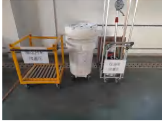
危险废物库内部
