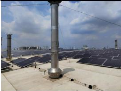
热处理燃烧尾气排气筒 P310-15
