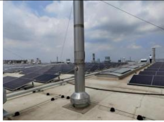
热处理燃烧尾气排气筒 P310-14
