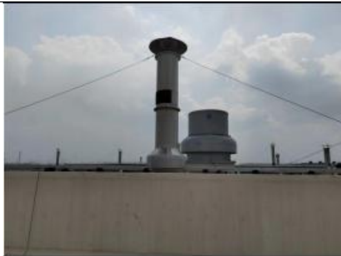
气体发生器燃气废气排气筒 P310-19
