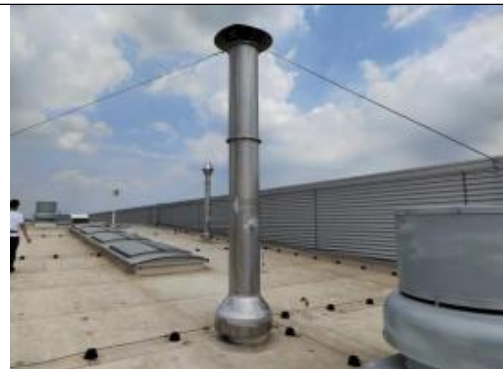
热处理燃烧尾气排气筒 P310-18
