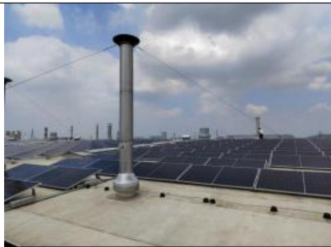
热处理燃烧尾气排气筒 P310-17
