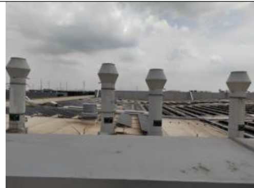
浸渍烘干废气排气筒 P310-23-26
