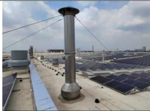
热处理燃烧尾气排气筒 P310-16
