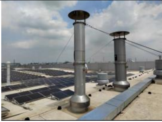
热处理燃烧尾气排气筒 P310-13
