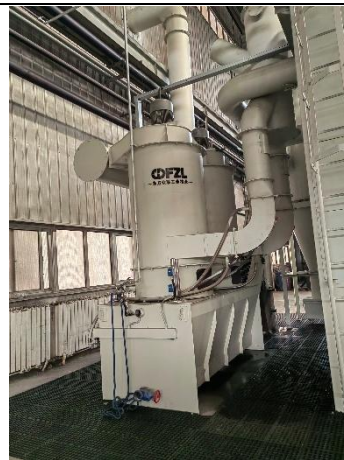
沉降室+湿式除尘器
