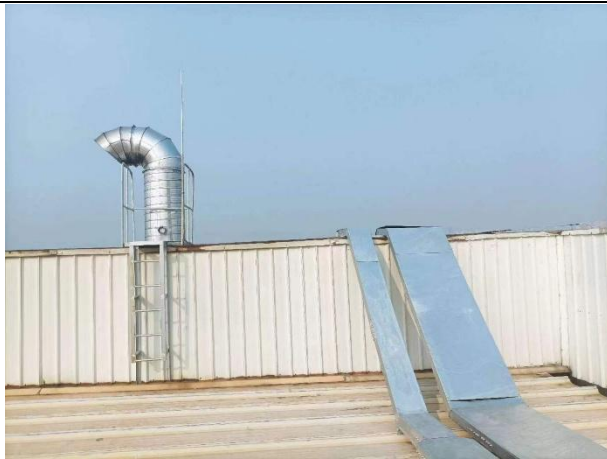
抛丸废气排气筒 DA010
