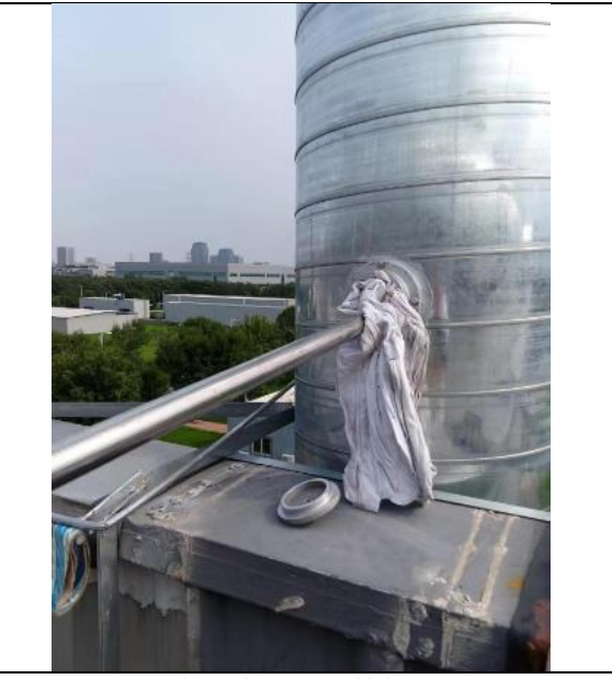
排气筒 P29 采样口
