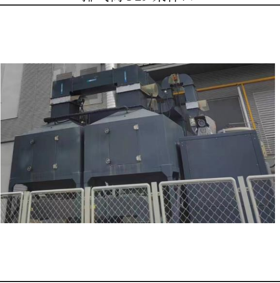
排气筒 P29 废气治理设施“活性炭吸脱附+催化燃烧装置”
