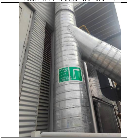
排气筒 P29 标识牌
