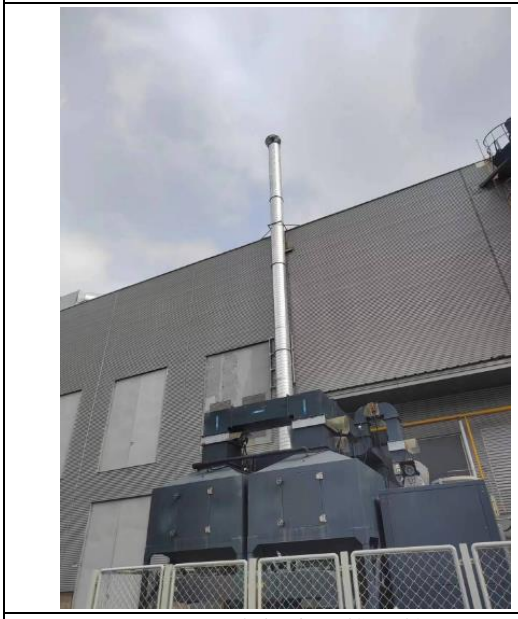
调漆、烘干有机废气排气筒 P29
