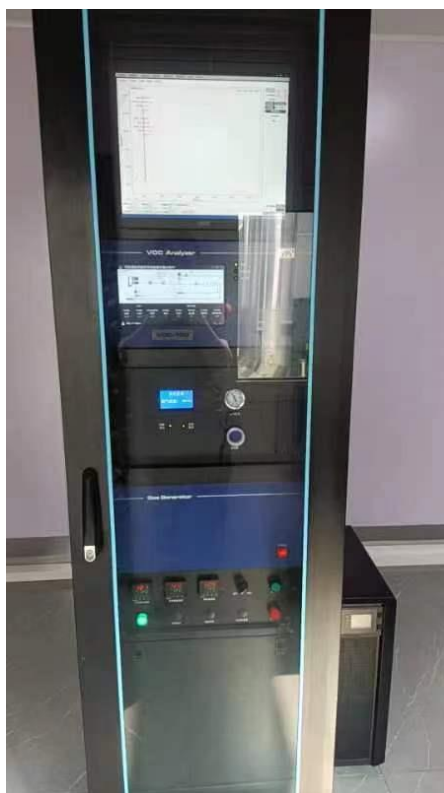
图 4.2-1 排气筒 P33 在线监测装置
