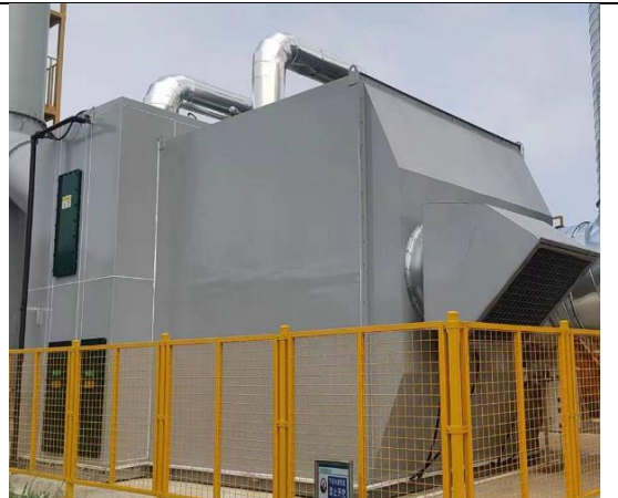
喷漆废气治理设施“沸石转轮+催化燃烧装置”
