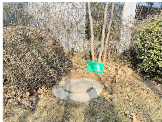
实验室废水排放口
