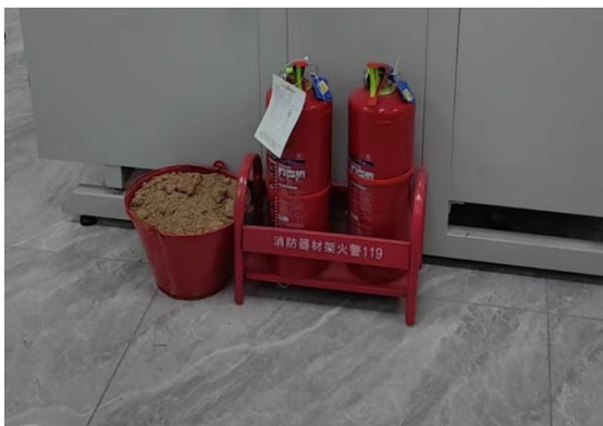
消防沙、灭火器
