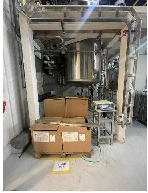
新增回用罐及缓冲罐
