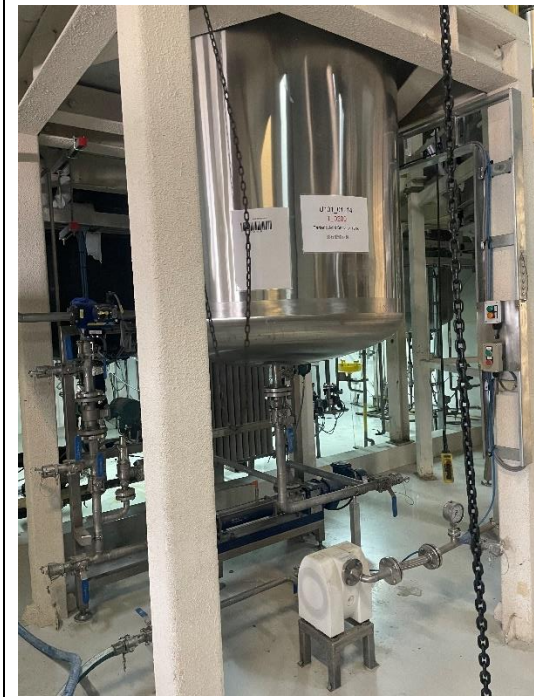
酒石酸储存罐
