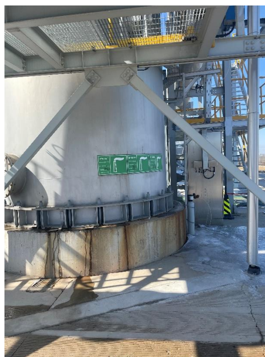
DA003、DA002、DA005 排气筒标识牌
