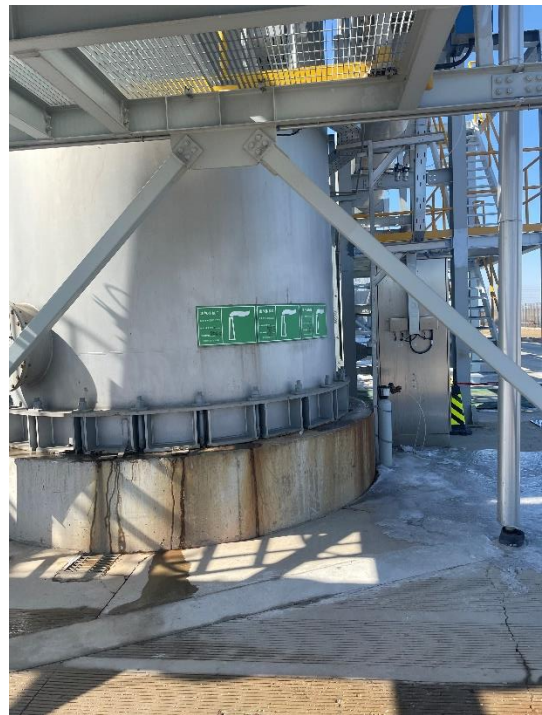
DA003、DA002、DA005 排气筒标识牌
