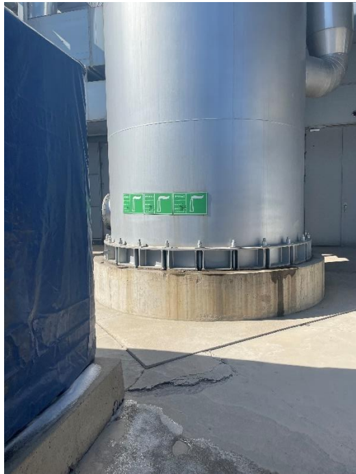
DA001、DA004、DA007 排气筒标识牌
