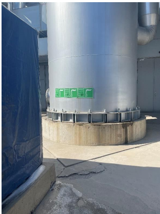
DA001、DA004、DA007 排气筒标识牌
