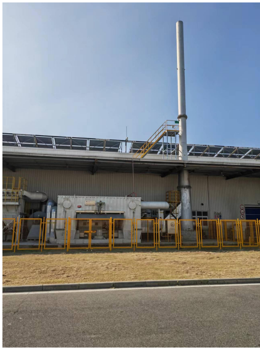
排气筒 DA003 及 Z 字梯
