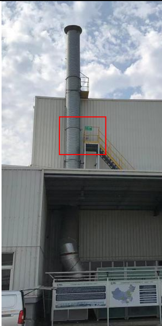
排气筒 DA002 采样平台及 Z 字梯
