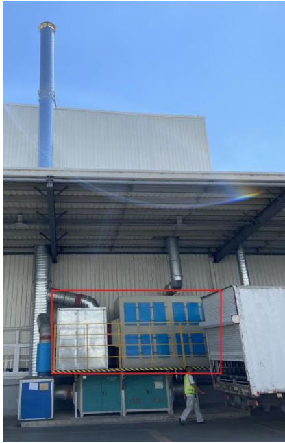
P1 排气筒及废气处理设施（红框内为本项目新增 1 套 UV 光氧+活性炭吸附设施）
