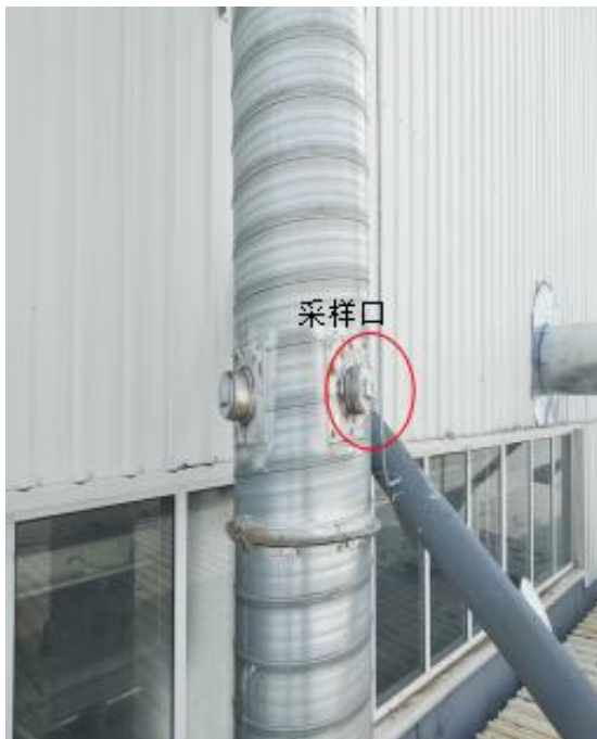
P1 排气筒出口
