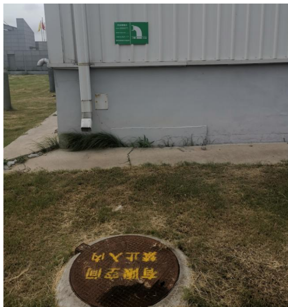
污水总排口及标识牌
