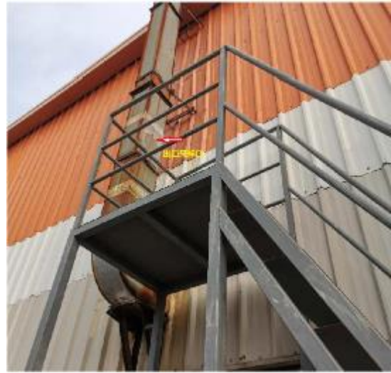
排气筒 P1 出口采样口+采样平台
