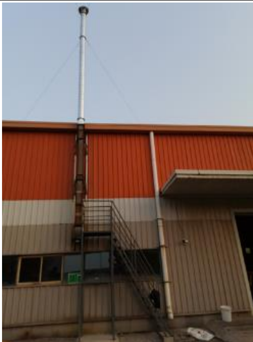
废气排气筒 P1 规范化
