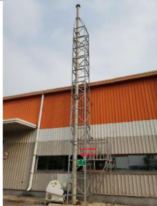
废气排气筒 P2 规范化
