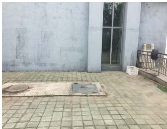
图 2.1-1 食堂废水隔油池
